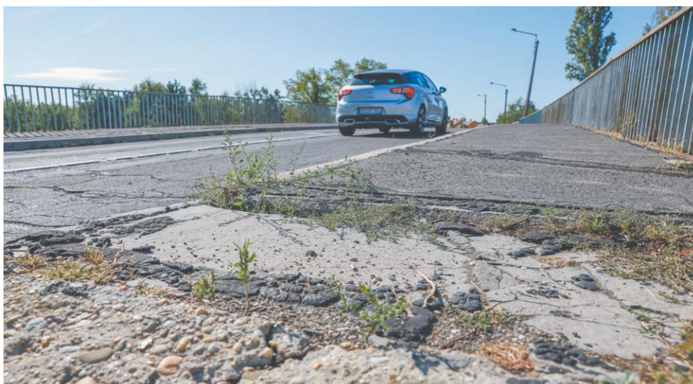
A megújításra váró Felüljáró út az M19-es fölött
